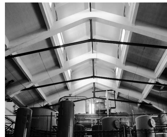
262. Villanytelep. Kapcsolóterem 263. Villanytelep. A gépterem tetőszerkezete 264. Villanytelep. Gépterem összképe
